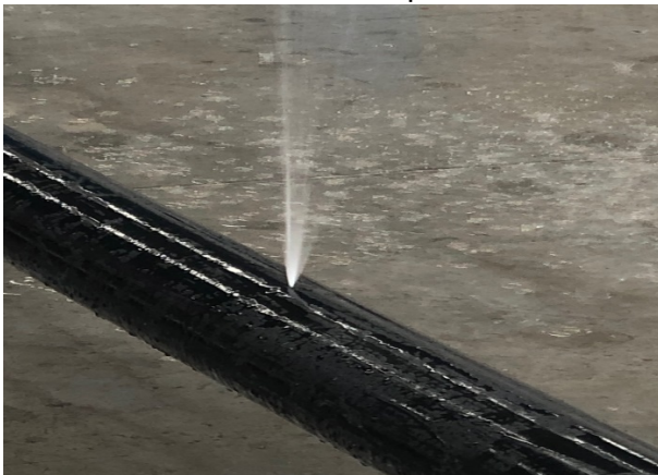
Antes de la reparación
